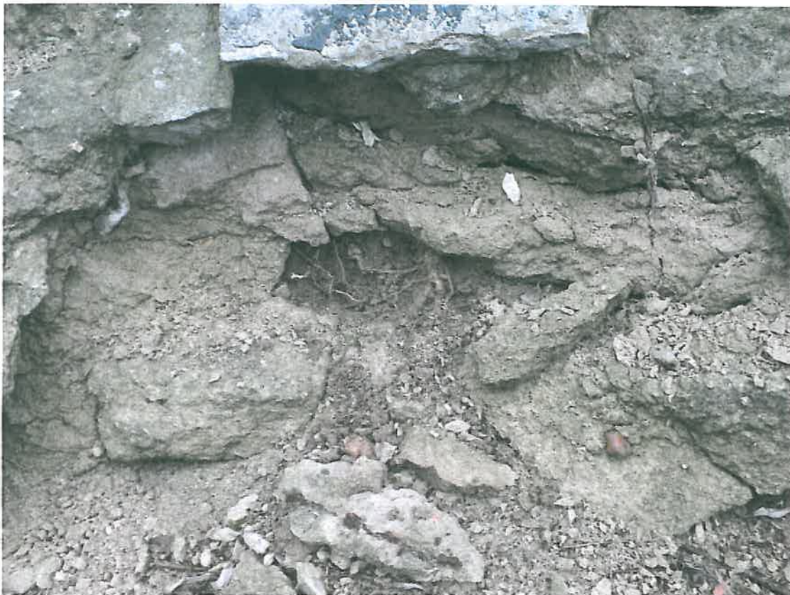
ZDJĘCIE 16- erozja betonu i rozwarstwienie struktury ścian basenu,
