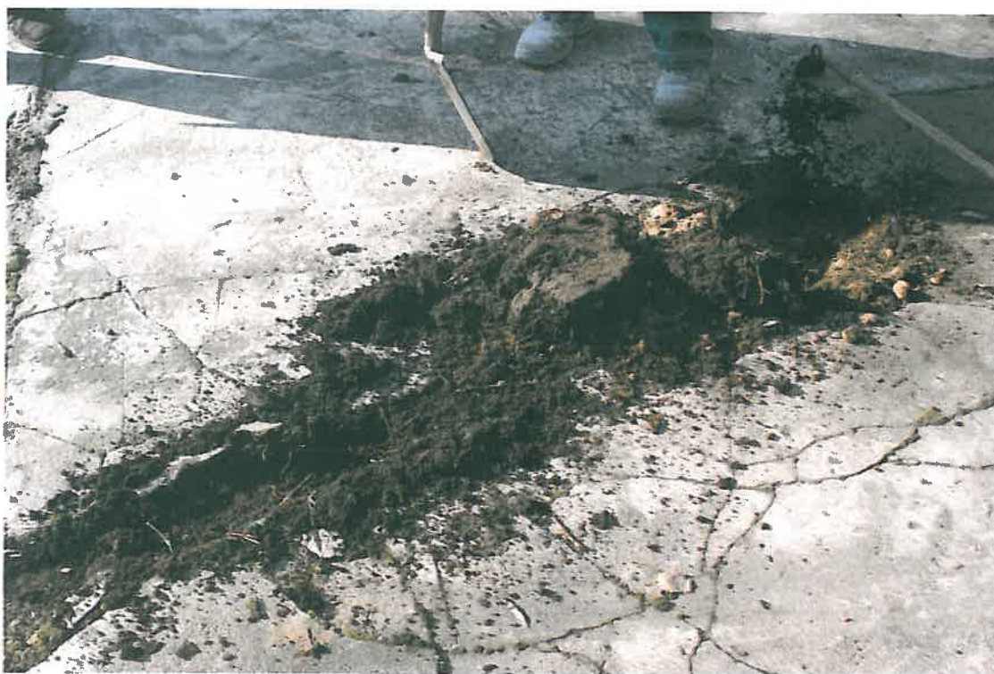
ZDJĘCIE 40- degradacja podłoża dna basenu przez system korzeniowy- zniszczenia struktur betonu,
