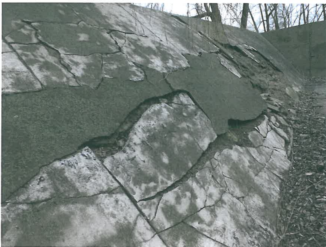
ZDJĘCIE 10- uszkodzenia ściany basenu od strony ogrodzenia,
