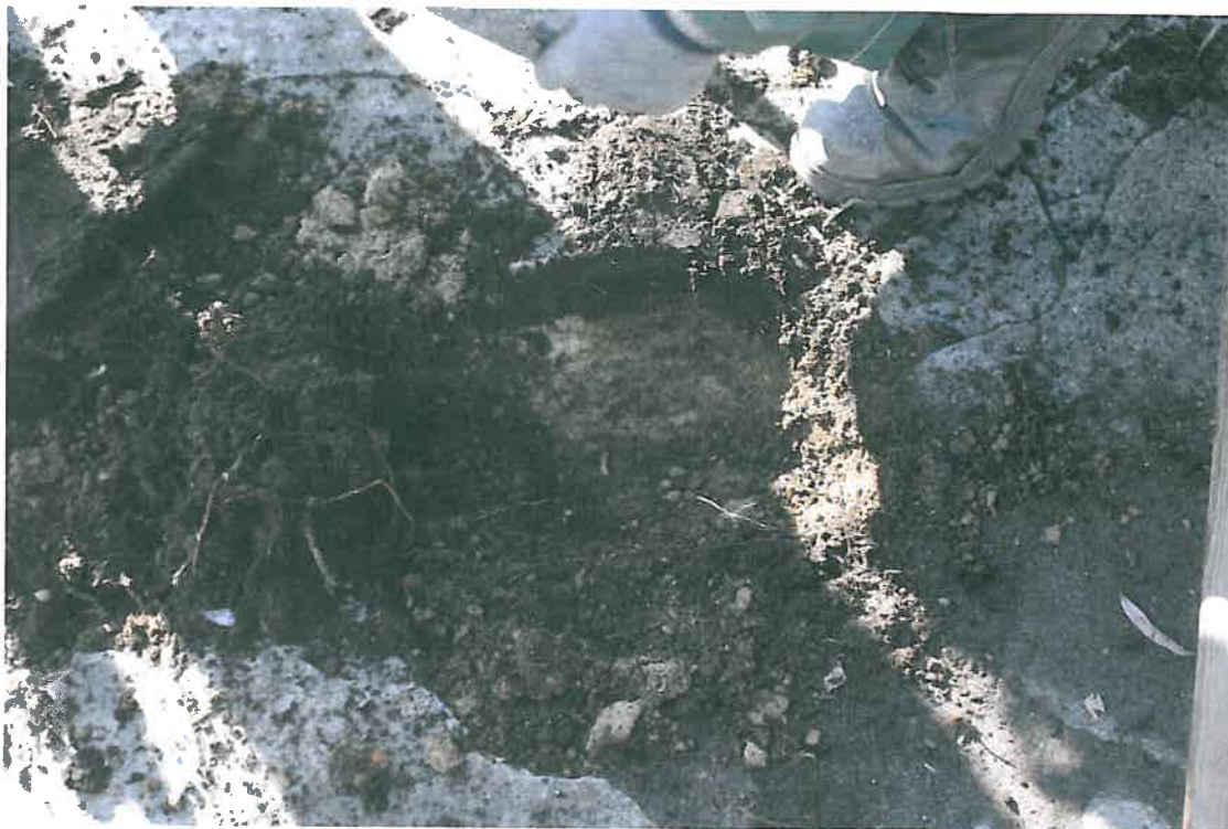
ZDJĘCIE 39 - degradacja podłoża dna basenu przez system korzeniowy- zniszczenia struktur betonu,
