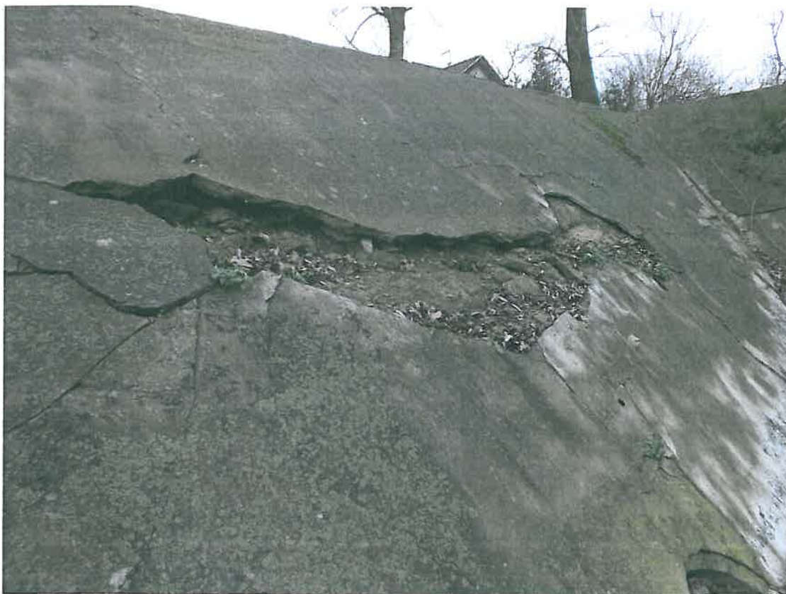
ZDJĘCIE 7- uszkodzenia ściany basenu w której znajduje się odpływ kanalizacji deszczowej,
