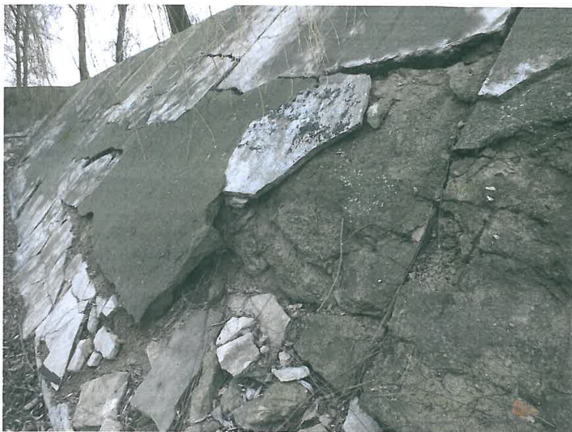
ZDJĘCIE 11- zbliżenie ubytków ścian basenu,
