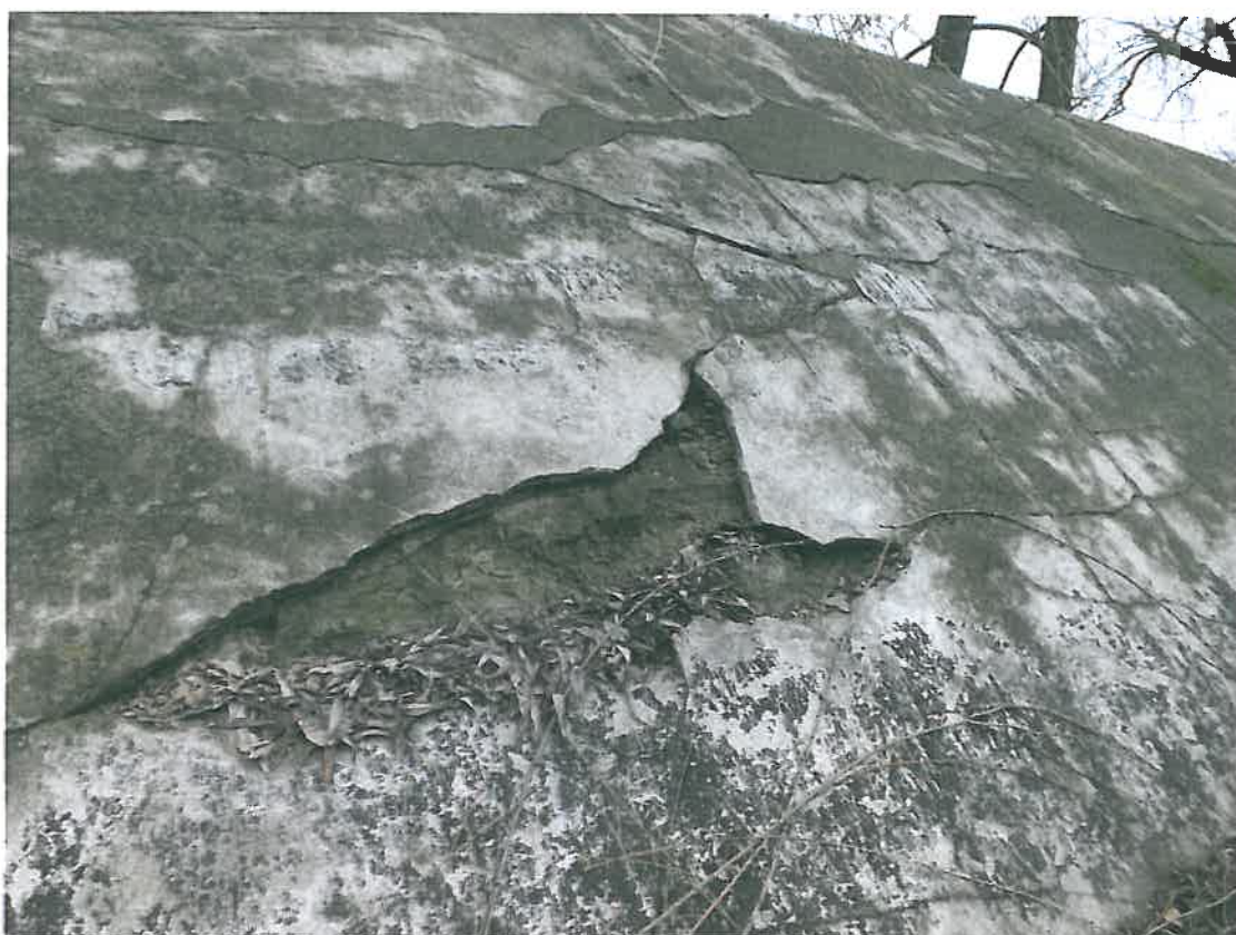
ZDJĘCIE 8- uszkodzenia ściany od strony drogi,
