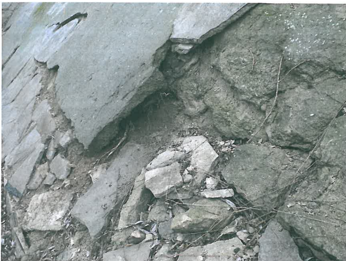
ZDJĘCIE 13- degradacja poszczególnych warstw betonu i podłoża ścian basenu,
