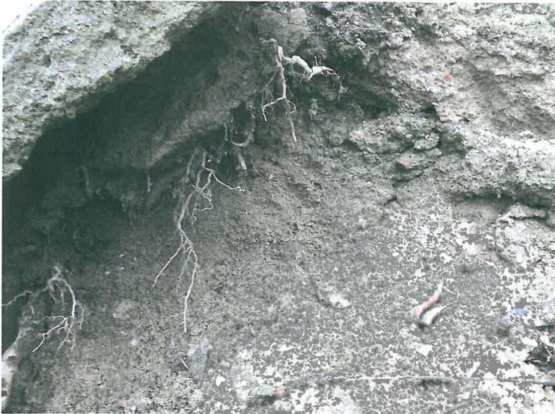
ZDJĘCIE 15- zbliżenie ubytków dokonane przez system korzeniowy drzew,
