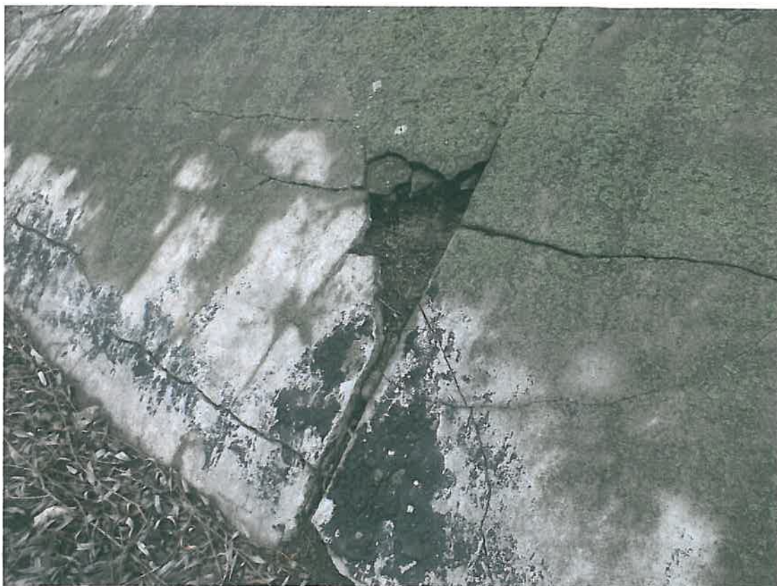
ZDJĘCIE 9- uszkodzenia ścian na styku z dnem basenu,
