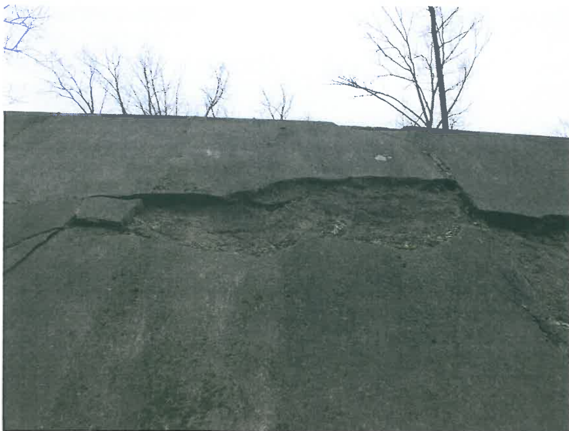
ZDJĘCIE 12- zbliżenie ubytków ścian basenu,
