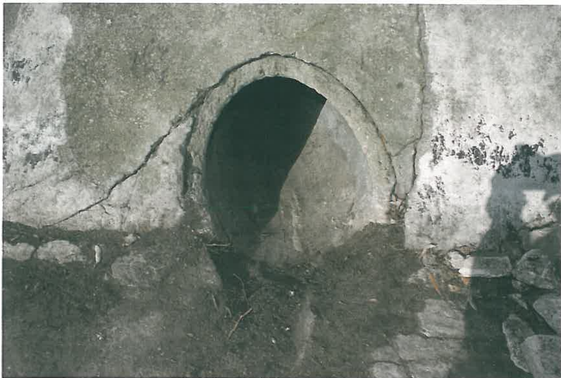
ZDJĘCIE 18- odpływ kanalizacji deszczowej z dna basenu,
