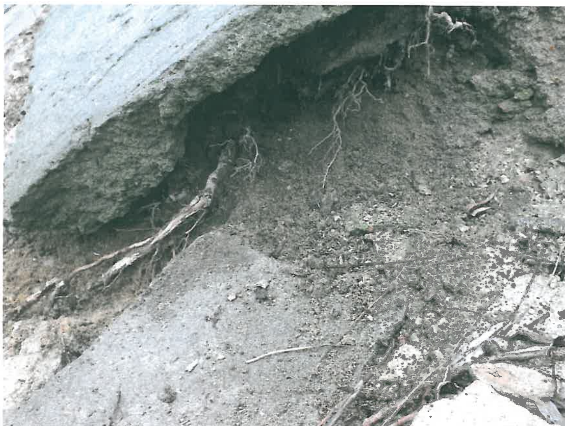
ZDJĘCIE 14- zniszczenia dokonane przez system korzeniowy drzew,
