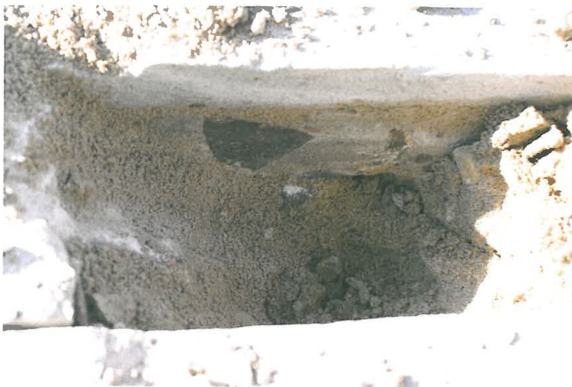
ZDJĘCIE 20- widok struktur betonu dna basenu,
